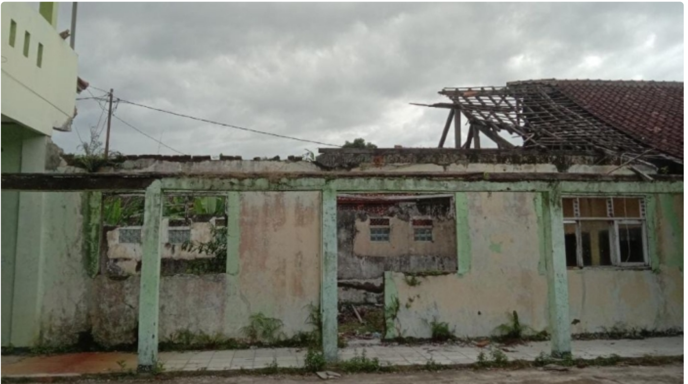
Bangunan Sekolahnya Rusak Parah, Ini Kata Kepsek Mts Albairuni
